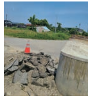
隆起したマンホール
